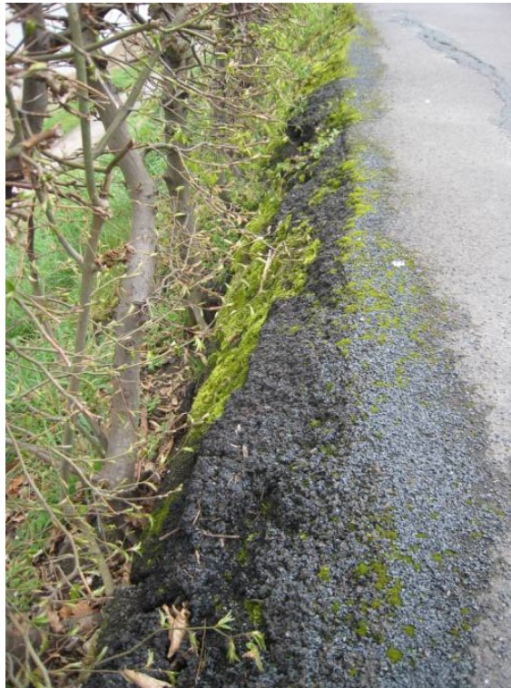
Bild 4: Gehweg mit Längsrissen und repariertem Randbereich
